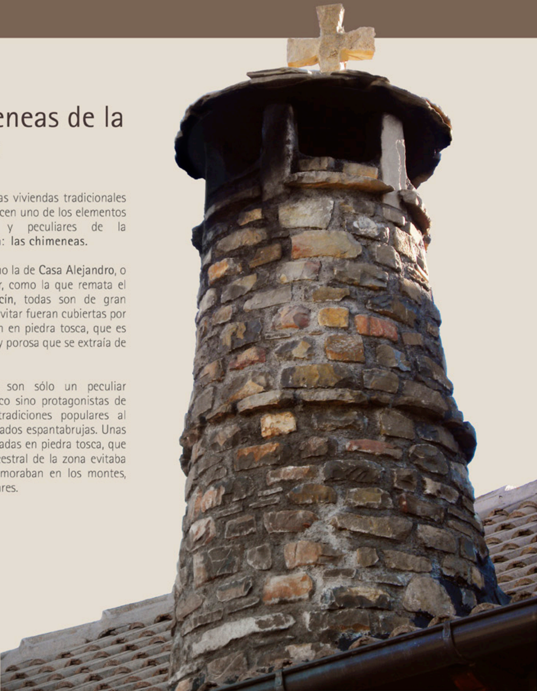
Chimenea de Casa Alejandro.
